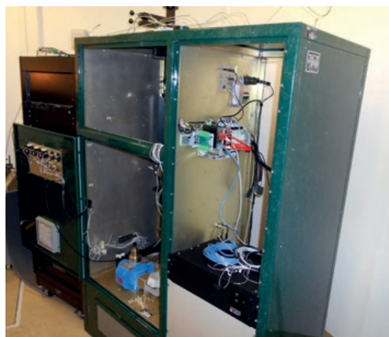
A radarvezérlő szekrény felújítás alatt
