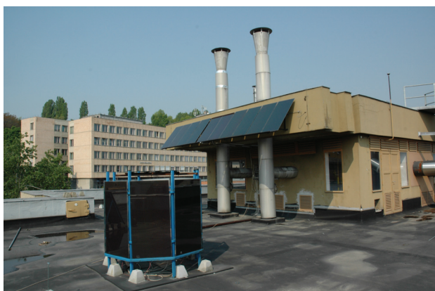
1. ábra: Napelemek a Bécsi úti épületen
